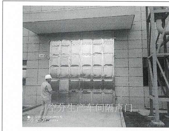
噪声治理设施现场照片
